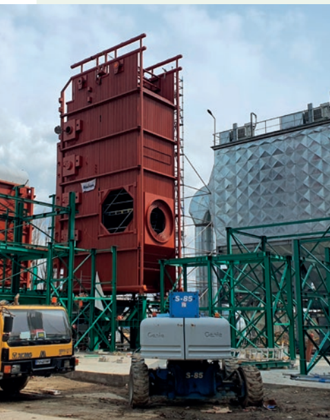
Unité de cogénération Expur, Roumanie
